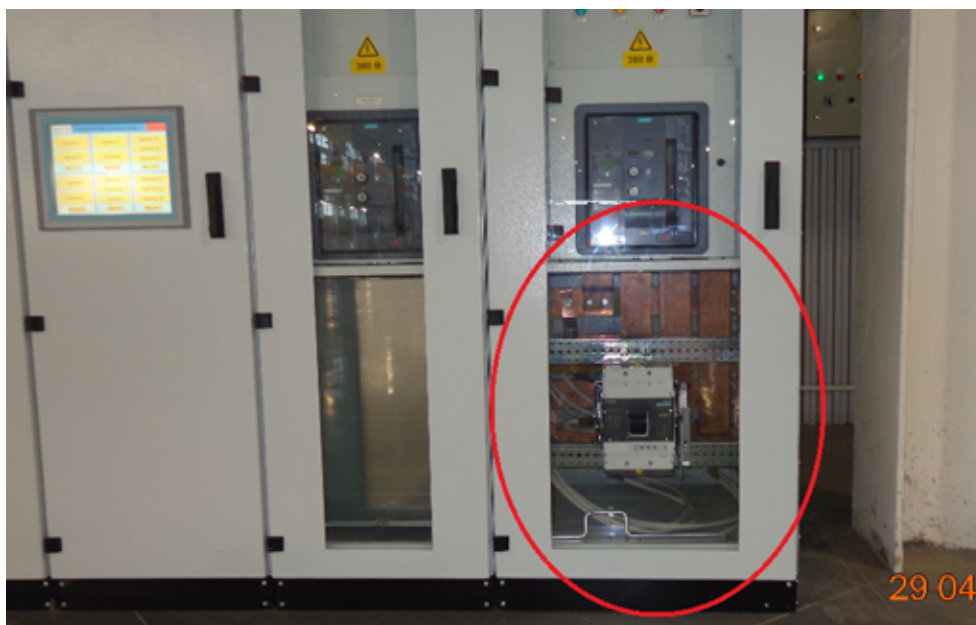
Рисунок 1.2 - Главный распределительный щит-1
