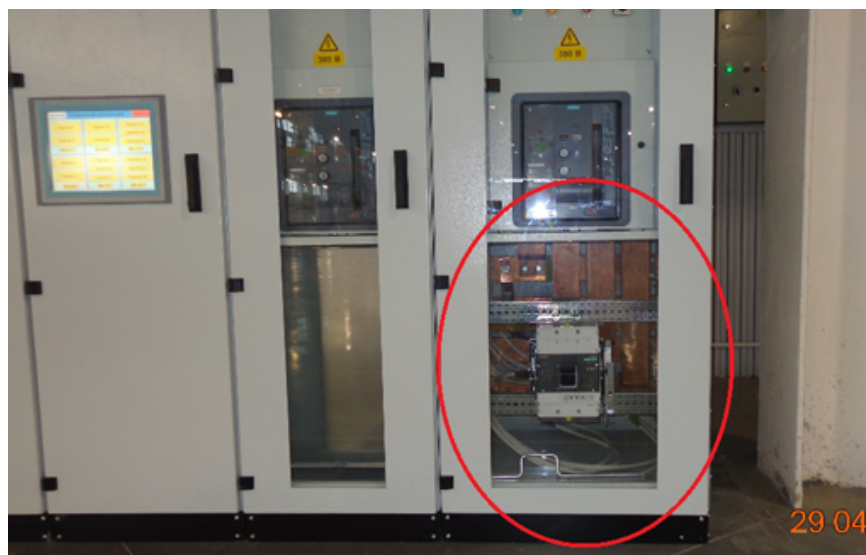
Рисунок 1.2 - Главный распределительный щит-1
